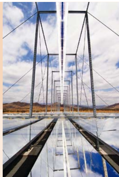
GB Fresnel collector (Source: DLR/Markus Steur)
